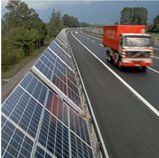
Figuur 2.5 Enkelzijdige zonnecellen in optimale 45° configuratie aan de A13 te Zwitserland
